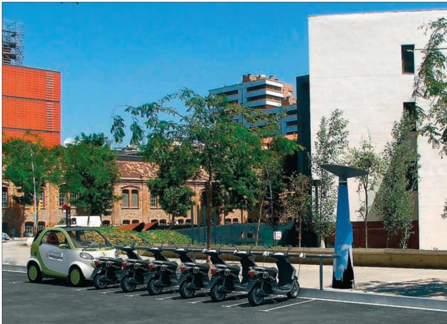
Punt de recàrrega ràpida per a cotxes i motos elèctrics situat en el districte 22@Barcelona.
