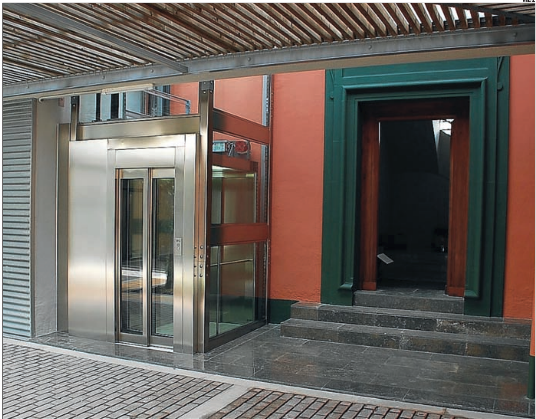
Ascensor amb accés exterior instal·lat després de la rehabilitació d'un edifici de vivendes al barri de Sant Gervasi, a Barcelona.
