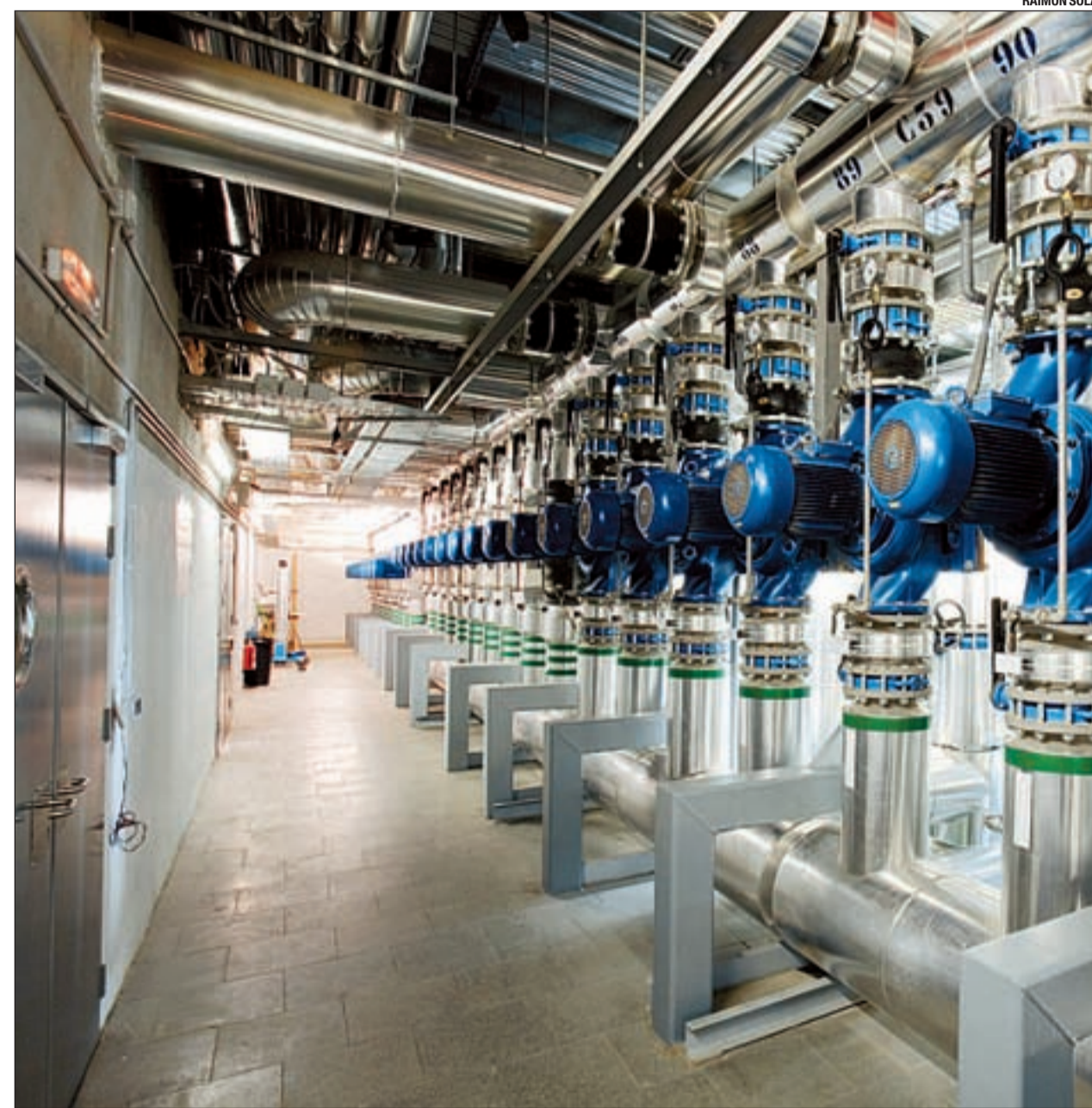
Sala de bombes de climatització al soterrani d'un edifici.
