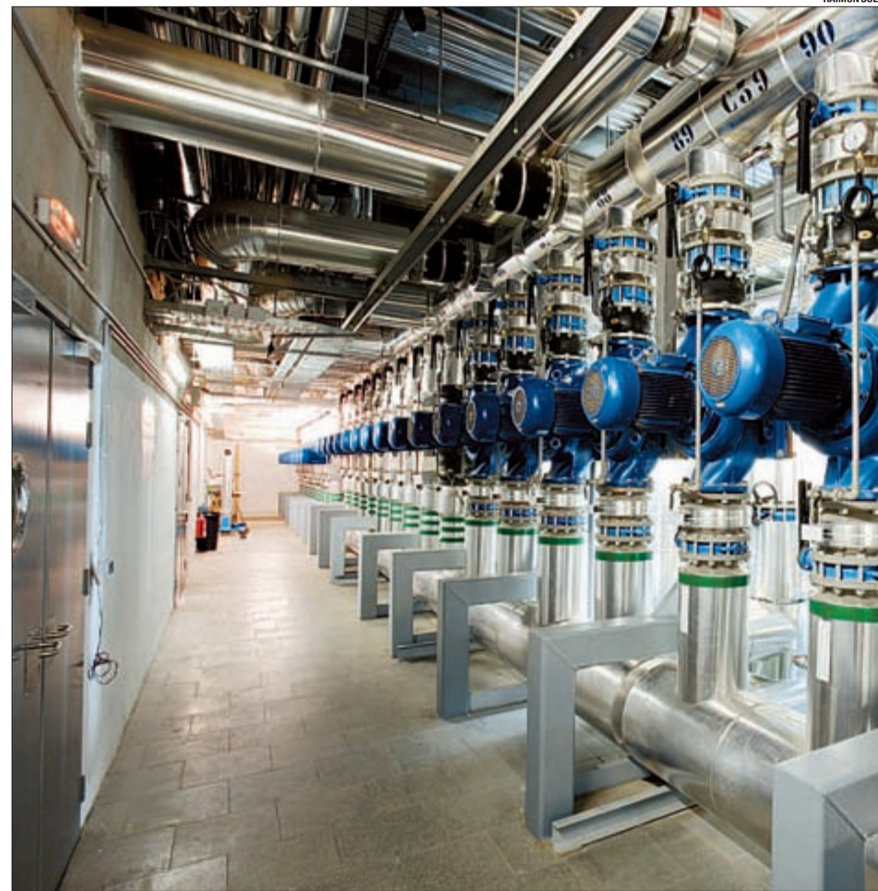
Sala de bombas de climatización en el sótano de un edificio.
