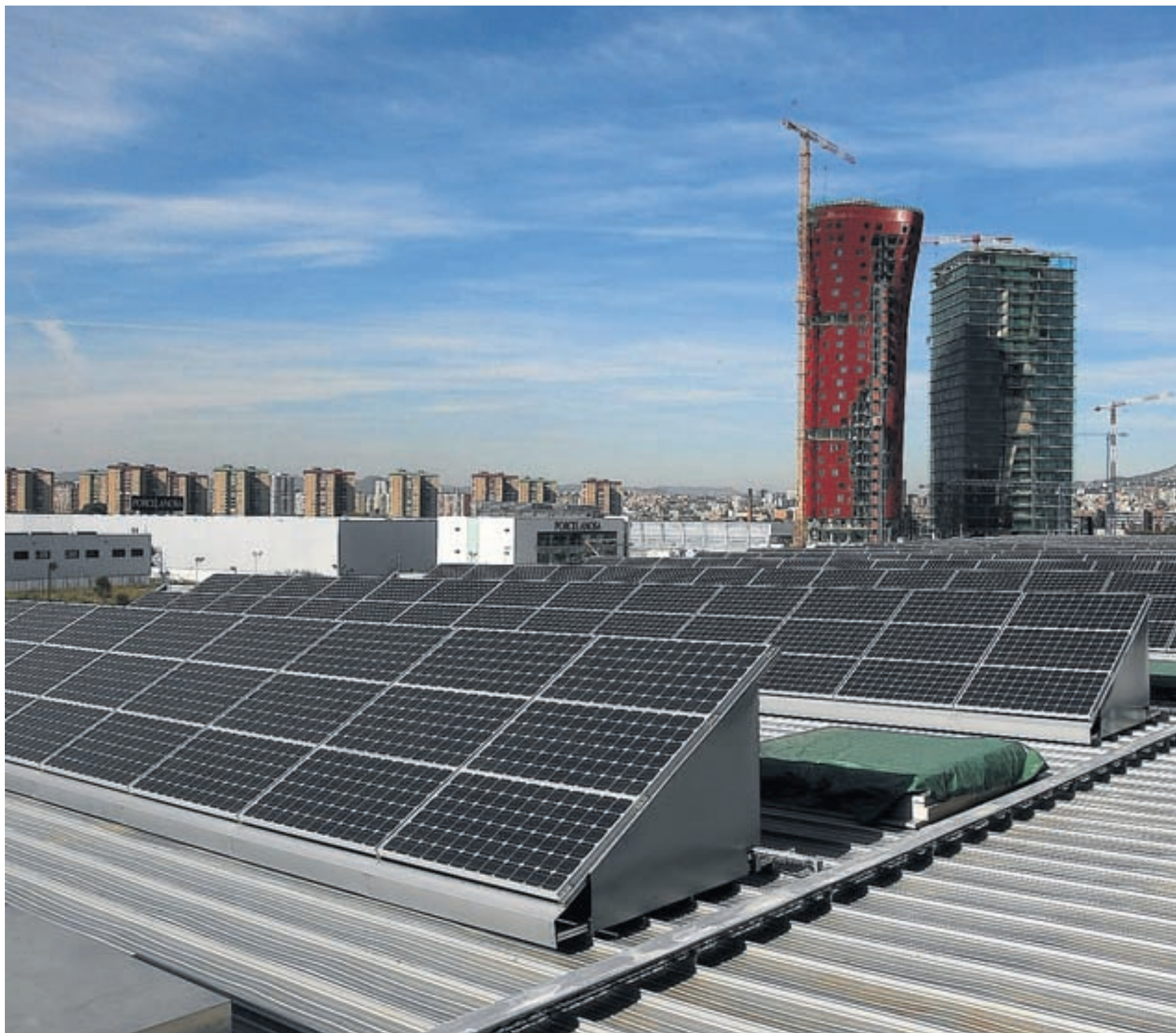
Placas fotovoltaicas instaladas en las cubiertas del recinto ferial de L'Hospitalet de Llobregat.
